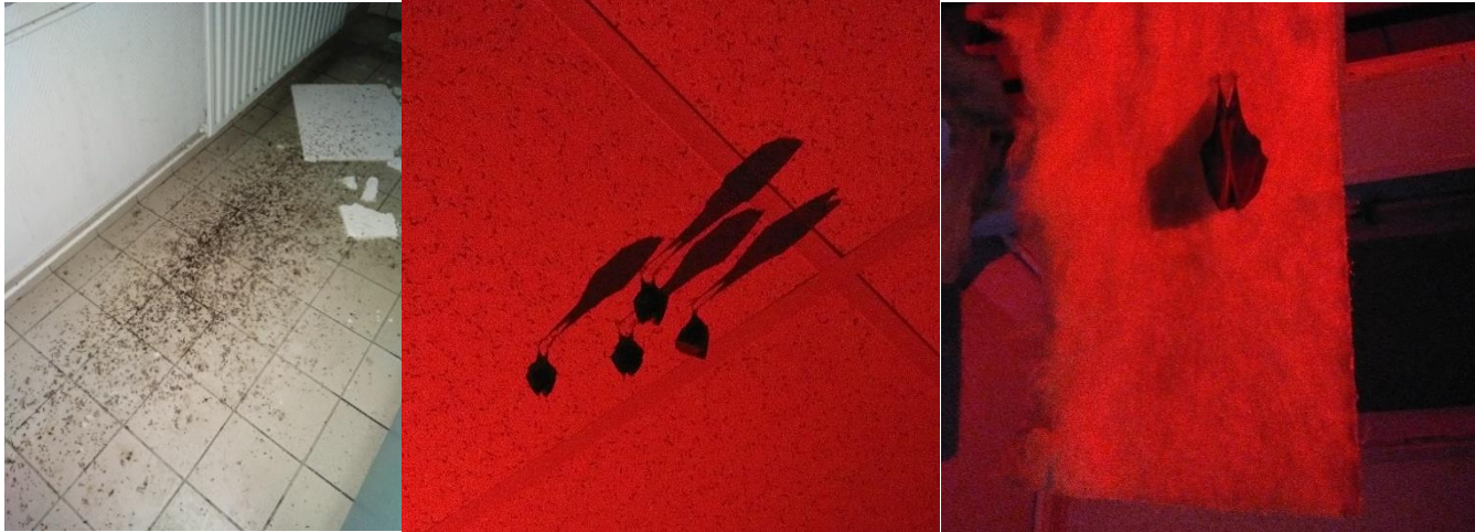
Figure 4 : Gauche = présence de guano importante signifiant la présence passée d'une colonie. Au centre et à droite = Petits rhinolophes observés en hiver sur le faux plafond et la laine de verre (Simethis, photos prises sur place le 20/01/2022)
